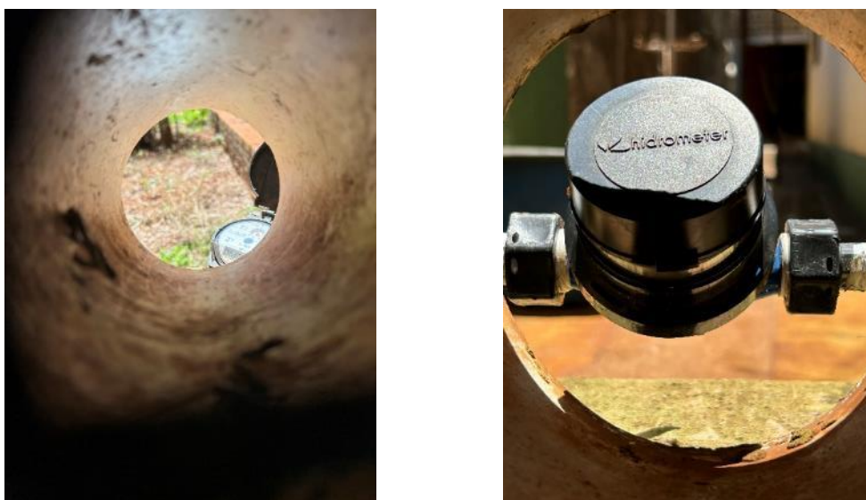
Figura 23: Hidrômetros no município de Barrinha/SP.
